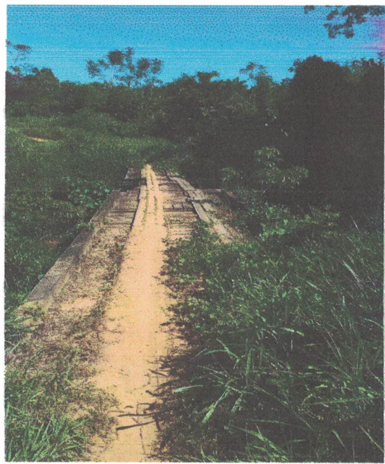
Ponte 31m interditada. Refazer 4°15'11.04S 56°17'06.91"O
